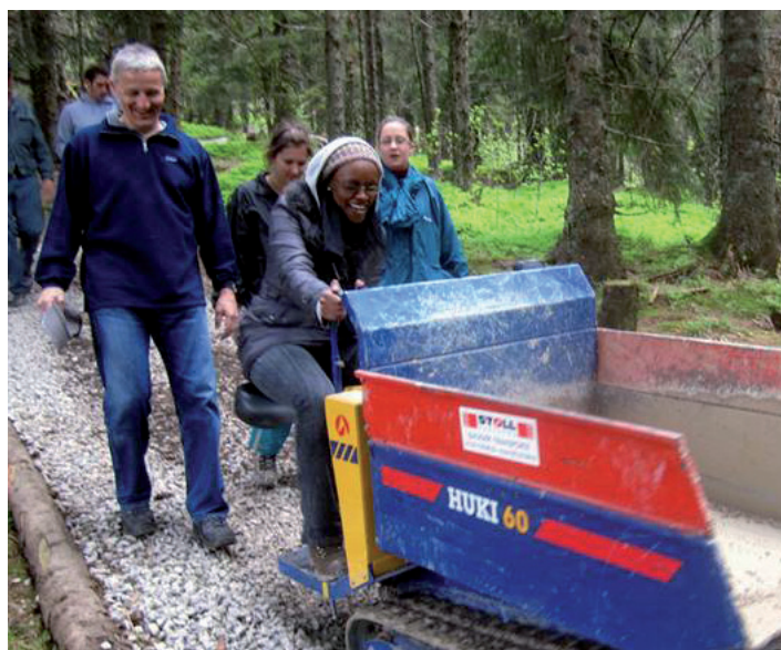
Travaux d'entretien du chemin panoramique du Gantrisch avec le RC Bern Bubenberg
